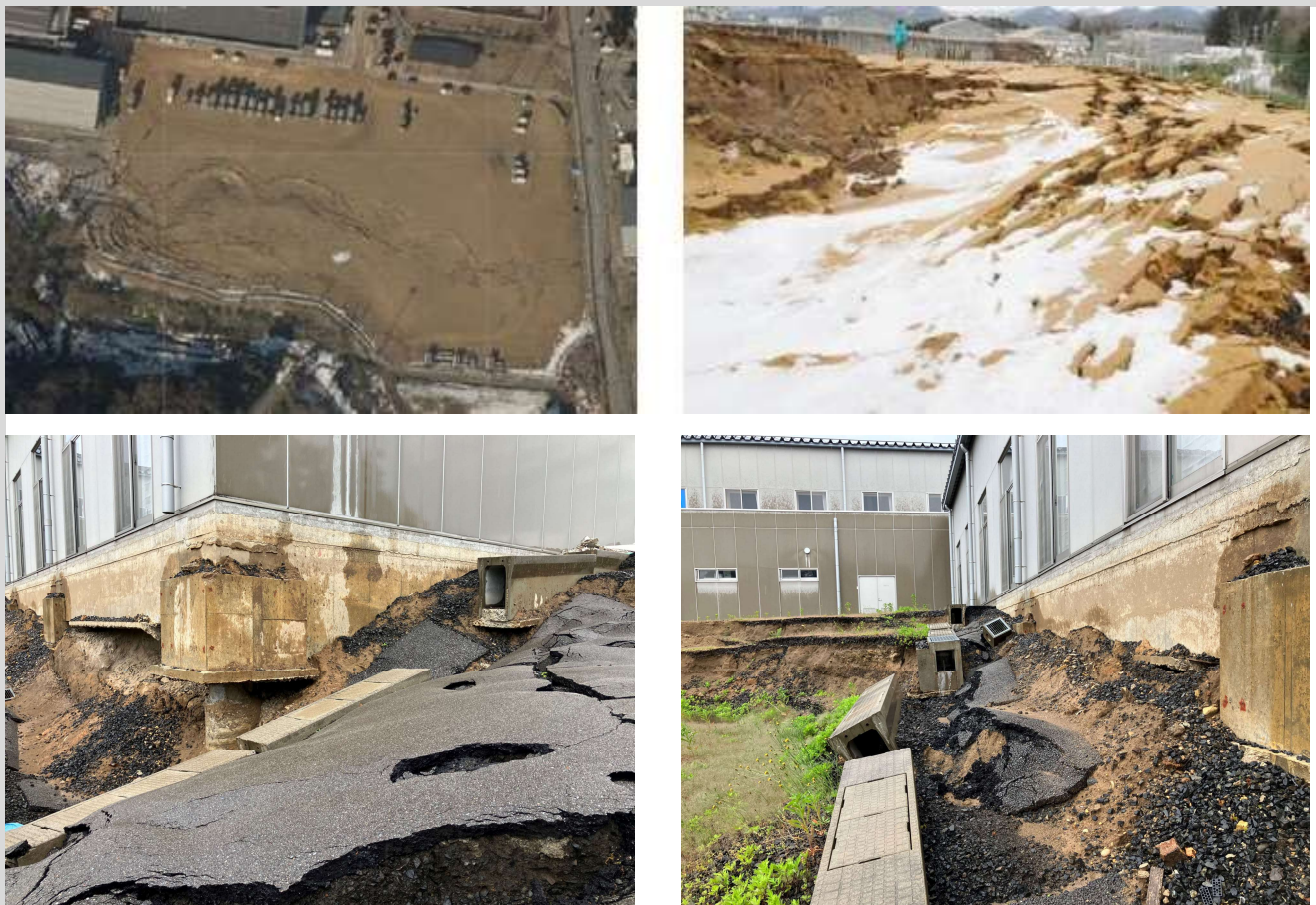
写真3.2 F中学校における被害状況
